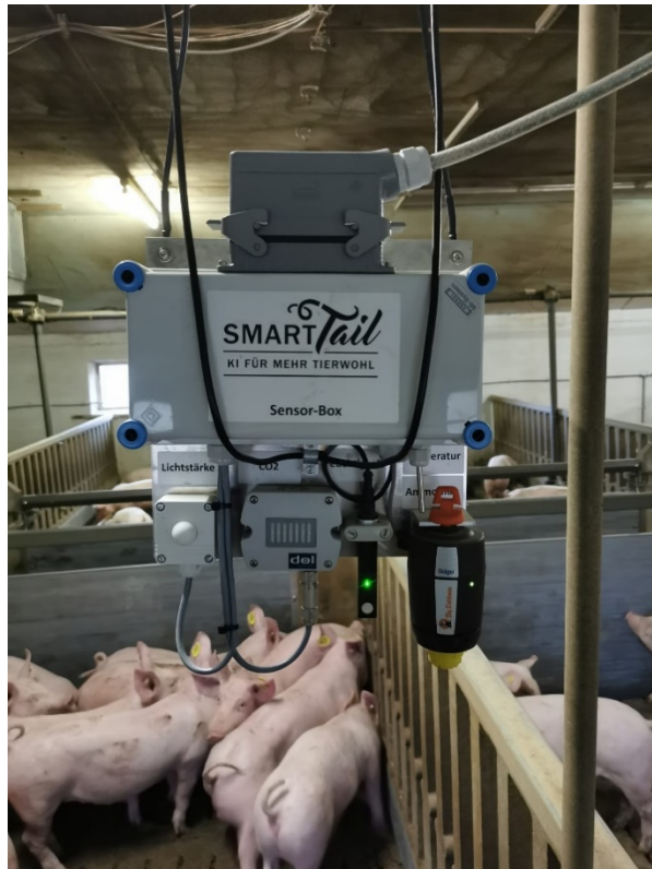
Abbildung 19: Im Stall installierte Sensorbox
